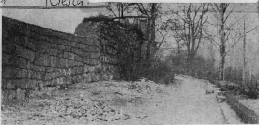
Keine Instandsetzung der Stadtmauer, sondern ein neues Mauerstück, steil und fremd wirkend
